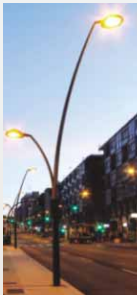
Luminarias de doble brazo y a distinta altura en la calle Ramón y Cajal. En la página siguiente, la calle Ramón y Cajal entre un mar de farolas y semáforos. Al fondo, el cruce con la avenida Pablo Iglesias.
