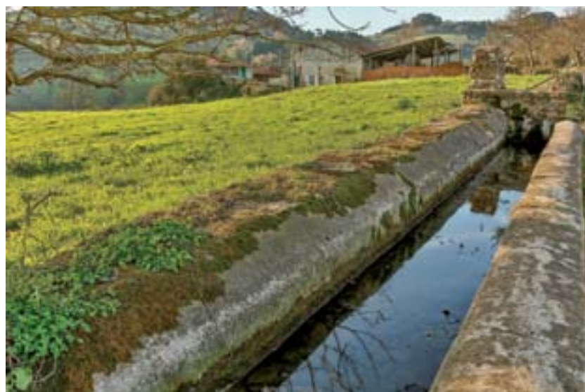
~ ARRIBA Batiao (Fuente, lavadero, abrevadero) L'Abadía Cenero. Camín de la Ermita de Santa Juliana Trubia (fuente, abrevadero) L'Abadía Cenero. Carretera de Trubia
