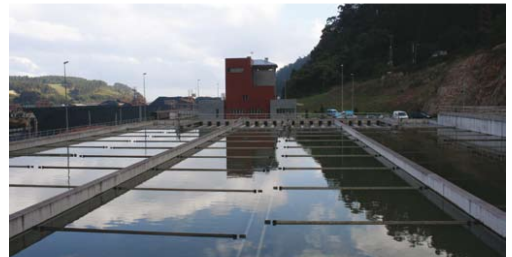
Instalaciones de la EDAR Gijón-Oeste en Aboño
