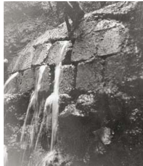
Fuga en el túnel del Campanal
