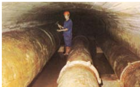
Galería visitable de la avenida de Schulz
